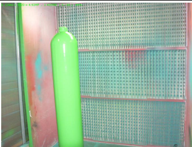
Zone de pistoletage à flux d'aspiration horizontal – aspiration à travers un filtre jetable avant rejet de l'air filtré par une cheminée en toiture.
