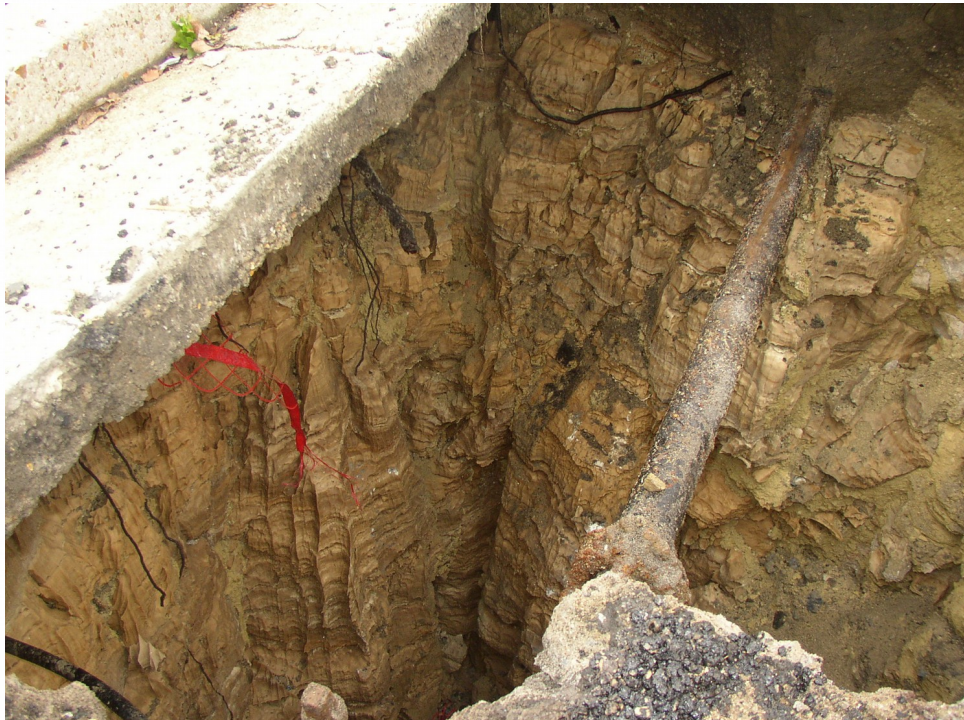
Exemple d'effondrement de chaussée suite à des fuites du réseau d'assainissement – Commune de Villetaneuse, butte de Montmorency
