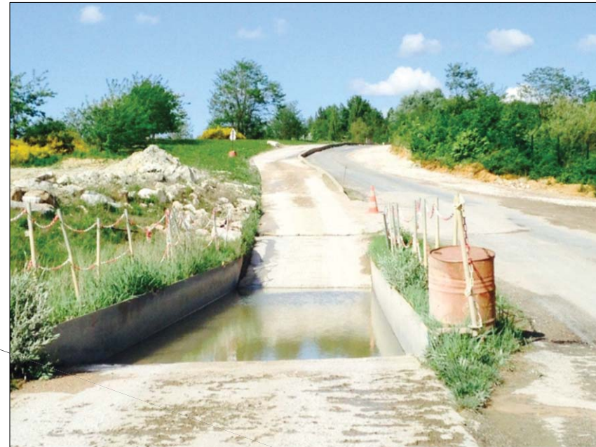
2 ème fosse pour la finition du lavage des roues des camions (lame d'eau en circuit fermé)
