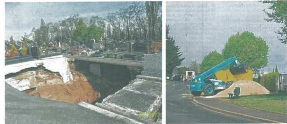
Cimetière nouveau de Sannois. Au total, douze sépultures (dont certaines vides) ont sombré dans le trou qui s'est ouvert. Pour éviter que d'autres caveaux ne tombent, les autorités envisagent de reboucher le trou et des dizaines de tonnes de sable sont en train d'être stockées près du cimetière. (DR)
